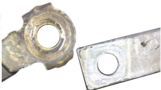
Рис. 1: Подключение заземления до очистки: слабый контакт
